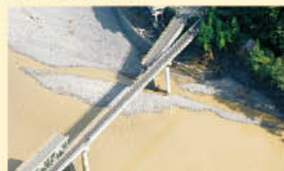
国道168号折立橋の落橋(十津川村折立)
