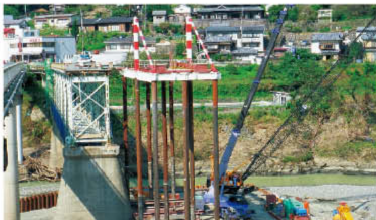
落橋した折立橋の国による復旧工事（10月12日）
