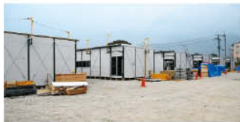
応急仮設住宅の建設(五條市岡口旧県立五條高校跡地 10月13日)
