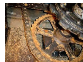
< 水処理施設 > 下水の水処理を行う施設 (27年経過)
