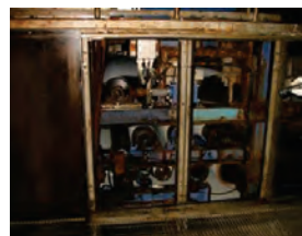
< 汚泥脱水・搬出施設 > 汚泥を脱水し搬出する施設 (18年経過)
