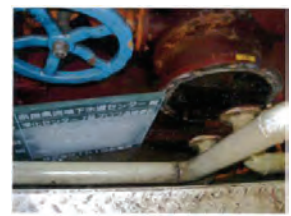
< ブロフ施設 > 処理槽に空気を送る施設 (39年経過)
