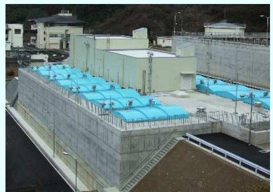
生物接触ろ過池
