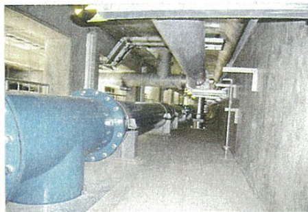
生物接触ろ過池管廊
