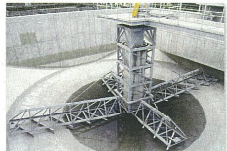
生物接触ろ過排水池
