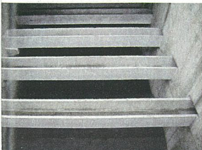
生物接触ろ過池内部
