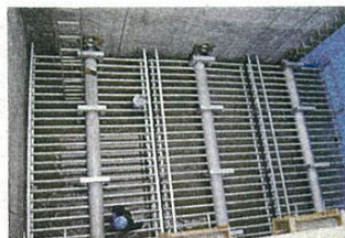
集水管・空気洗浄管
