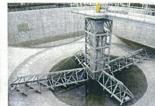
生物接触ろ過排水池
