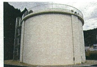
生物接触ろ過洗浄水槽
