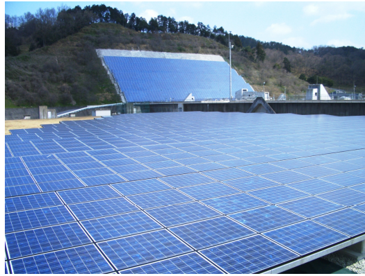
▲太陽光発電システム（御所浄水場）
