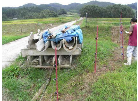
●獣害対策電気柵設置不具合調査
