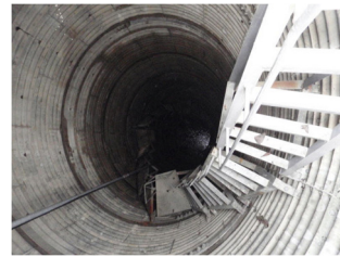
地すべり防止施設
