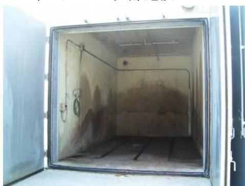
図1 乾式メタン発酵槽
