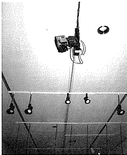
落下防止対策をした俯瞰用ビデオカメラ
