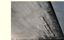
＜床版鉄筋露出＞
