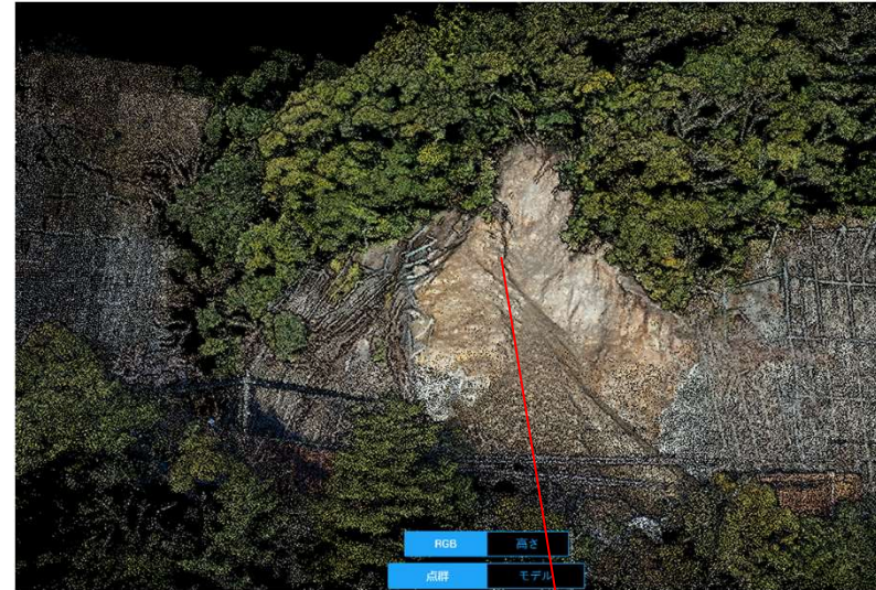
崩壊斜面全景
