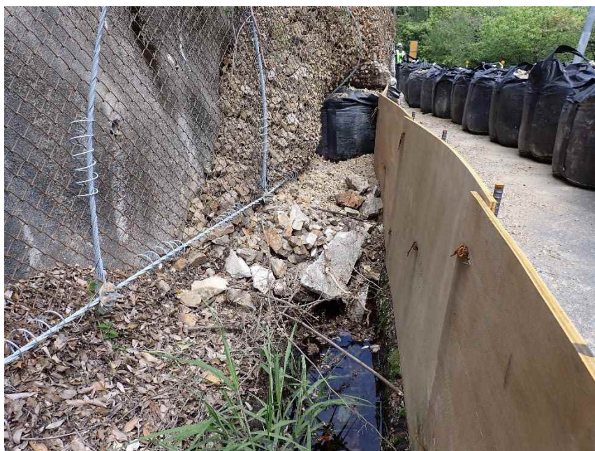
写真 3.6 ⑥はく落箇所状況（終点側から撮影） 路肩と法面の間にある水路は、流出土砂が堆積して閉塞している。
