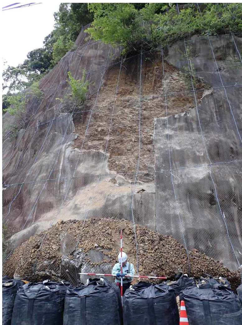
写真 3.1 ①モルタルはく落箇所の状況 (規模：幅 9m×高さ 10m×深さ 1m)
