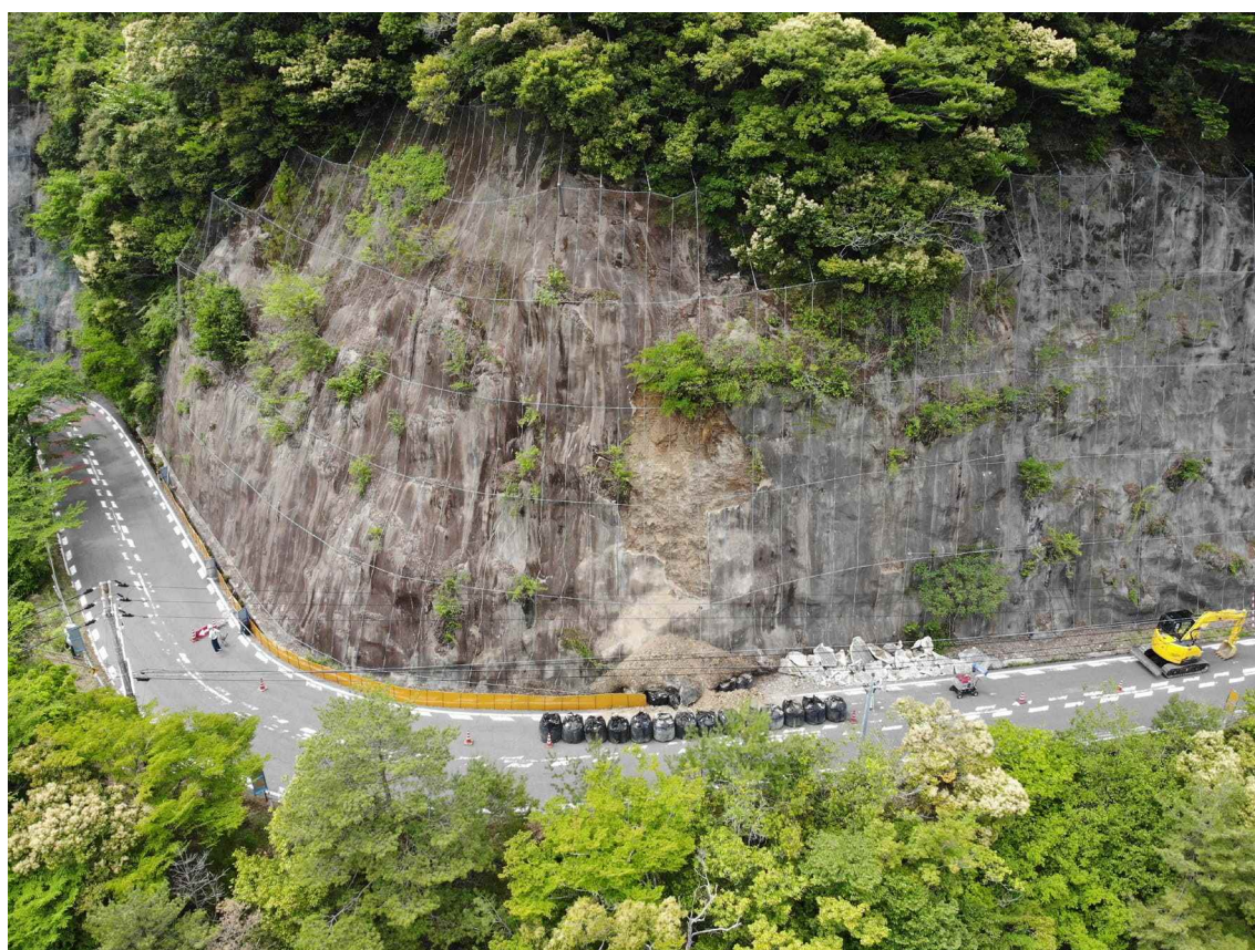
写真 2.1 モルタル吹付はく落箇所（写真提供：田中建設株式会）
