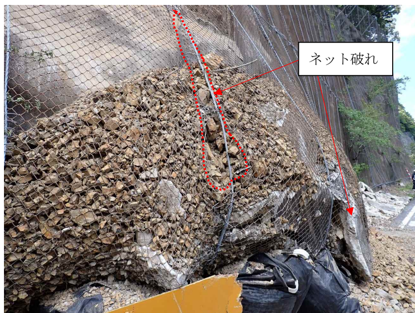
写真 3.4 ④ポケット式防護網裏の土砂堆積状況 流出した土砂により防護網の一部が破れている。
