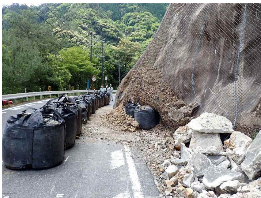
写真 3.5 ⑤はく落箇所の状況（起点側から撮影） 応急処置として、剥落したモルタル片は路肩に集められている。
