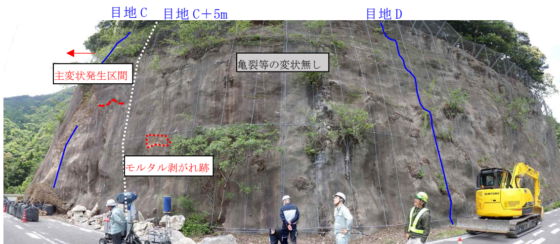
写真 3.7 ⑦主変状区間起点側の状況 変状の有無は目地 C より起点側に約 5m 程度の場所を境界とする。 目地 C+5m より左は変状が有るが、目地 C+5m より右は、一部モルタルの剥がれ跡があるのみで、亀裂等の変状は認められない
