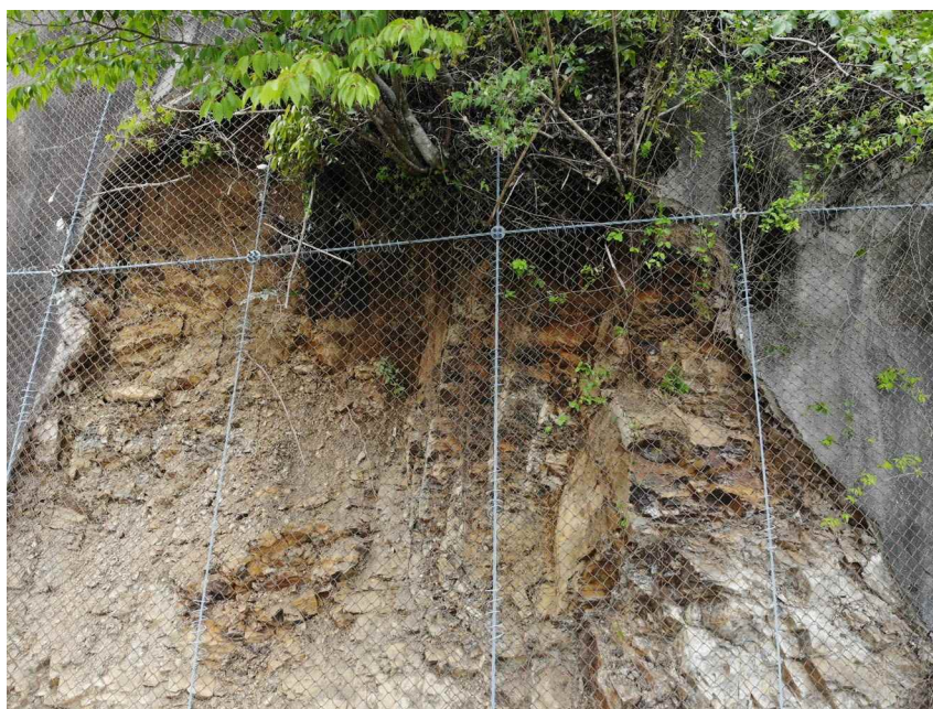
写真 3.3 ③はく落箇所頭部付近の状況（正面）（写真提供：田中建設株式会社） 崩壊深さは最大 1m 程度と推察される。
