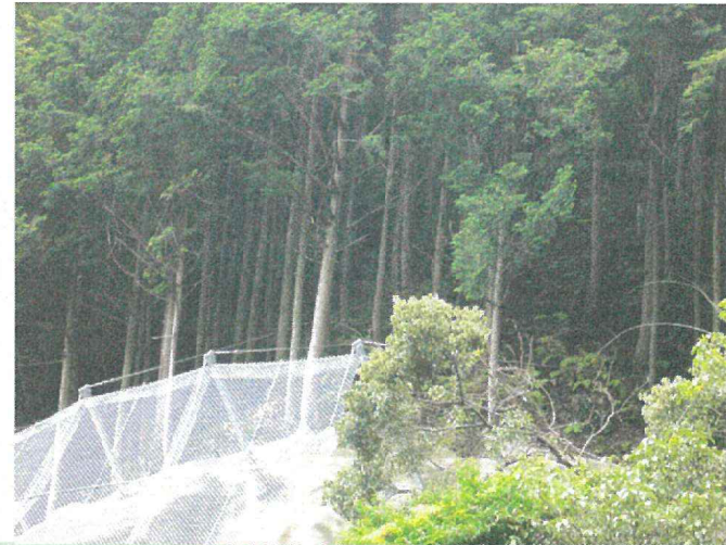
P-3 起点側法面上部には目立った転石は見られない
