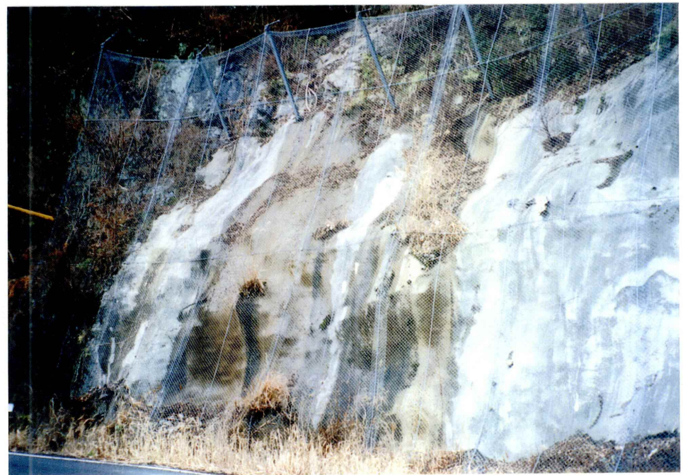
⑧吹付工より湧水
