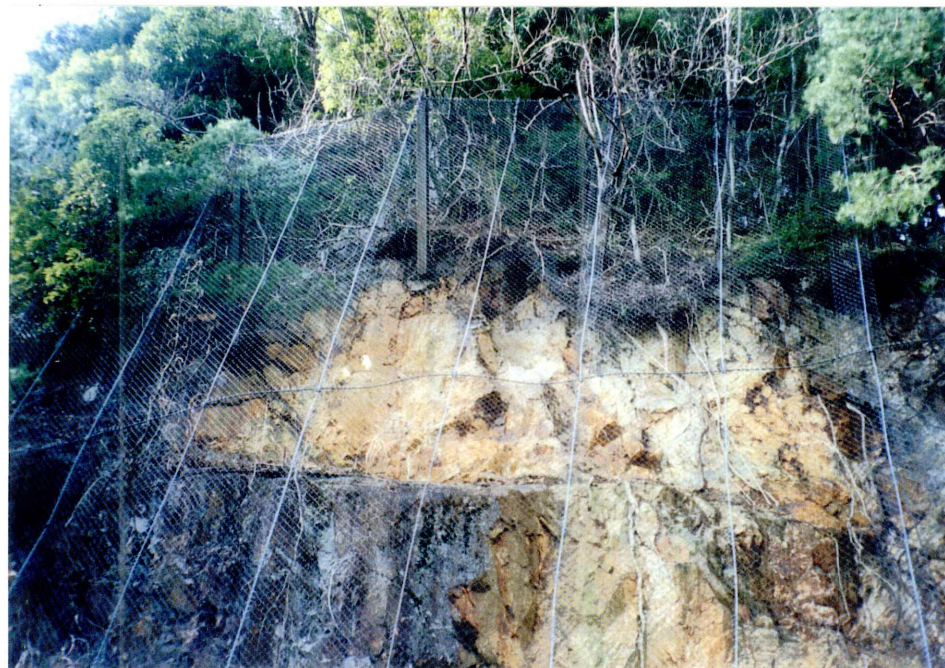
⑥法面上部のオーバーハング状露岩 開口亀裂が発達する
