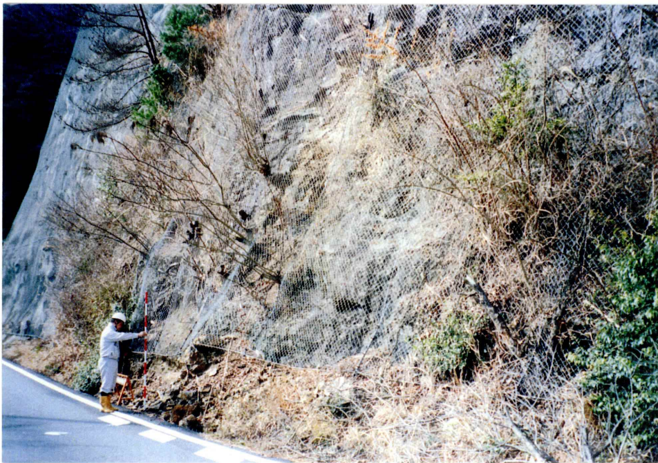
⑦無処理法面の表面が脆弱化し土砂状に剥落 法尻の水路に土砂及び落石が堆積
