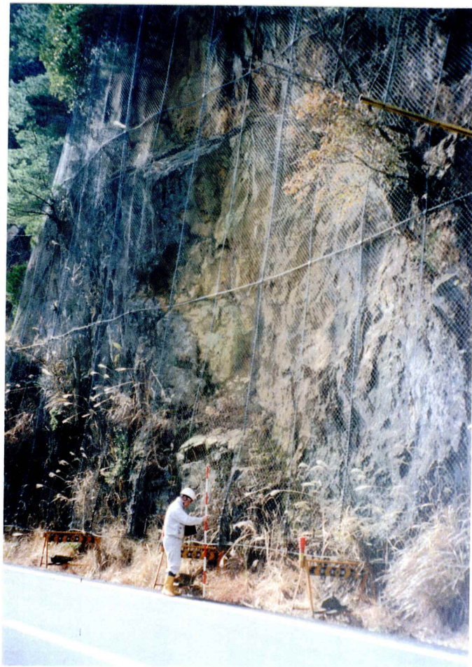
⑤法面の小崩壊 ロックネット内に落石状で留まる
