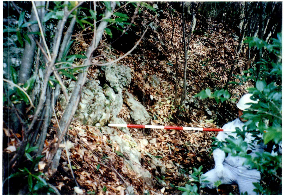
⑩斜面内の状況 亀裂の発達した露岩が分布
