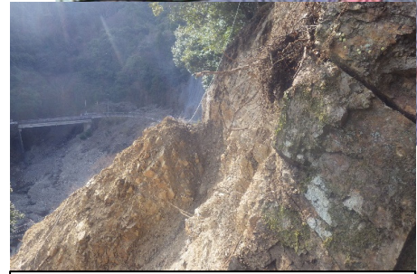
被災地頭部地質状況
