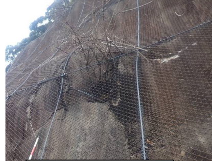
⑤モルタル座屈変形
