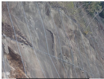
④モルタル座屈変形
