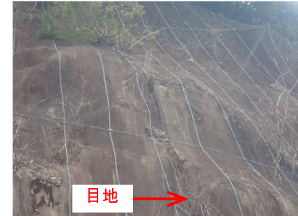
⑦目地部の孕み出し
