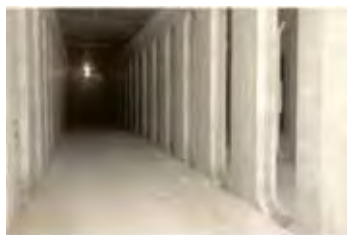
▲【供用中】地下貯留施設(田原本町)
