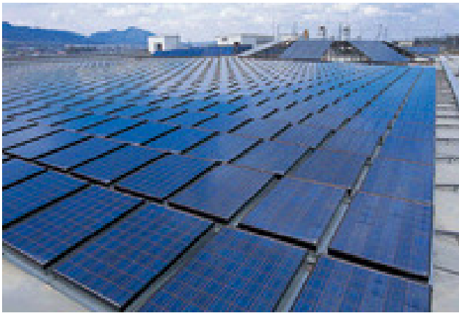
太陽光発電施設
