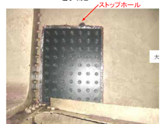
主桁ウェブ 当て板補強
