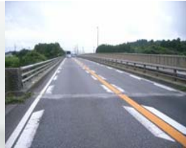
国道1号 白川橋(1960年架設) 安全性の観点から、緊急対応を実施(E)
