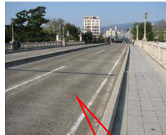
国道2号 武庫大橋(1926年架設) 速やかに補修する必要がある橋梁(C)
