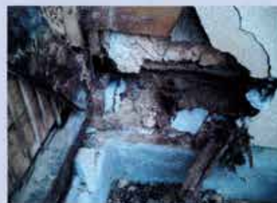
シロアリで土台がなくなっている
