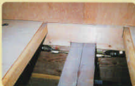
既設梁を引寄せ金物で緊結することにより、鉄骨フレームによる補強の効果を高めました。
