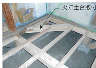
床の張り替えと火打土台取付により床の剛性を高めます。
