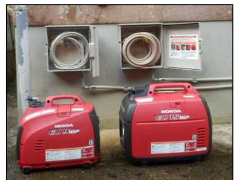
非常用LPガス発電設備
