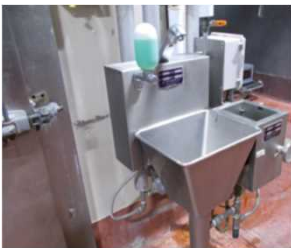
自動手洗い器の設置
