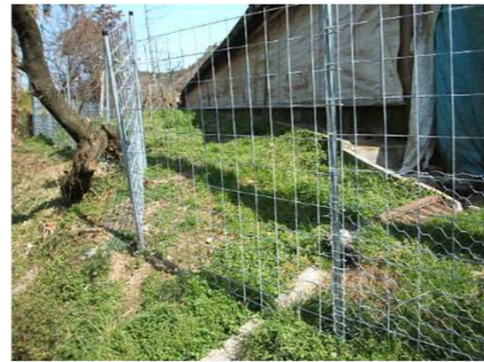
<野生動物進入防止フェンス>
