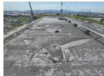
屋上防水の劣化(漏水)
