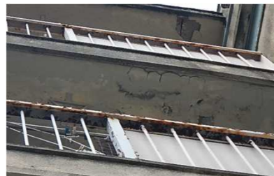
外壁・ベランダ部の劣化
