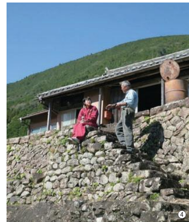
③解体の際に、床や天井の下に全く別の生活様式や暮らしが垣間見えるのだそう ④リノベーション作業を共にする大工の上垣さんと。休憩時間もいつの間にか設計や解体の話に
