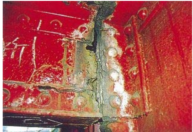
縦桁腹板の断面欠損
