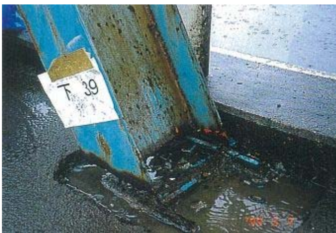
トラス橋斜材の破断
