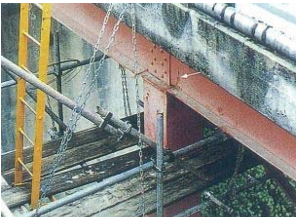
上路式アーチ橋の支柱部と補剛桁の取付け部に発生した亀裂
