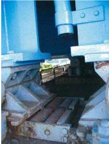
支承ローラーの脱落
