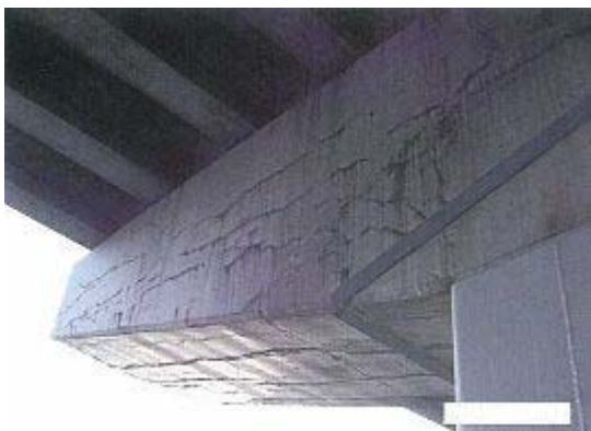
ASR と想定されるひびわれ（橋脚）
