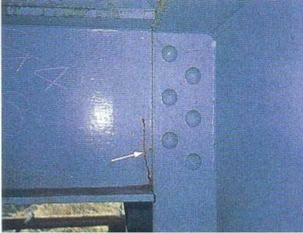
縦桁腹板に達した亀裂
