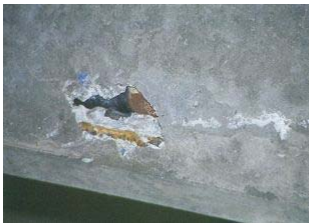
露出したシース管が腐食（PC橋）
