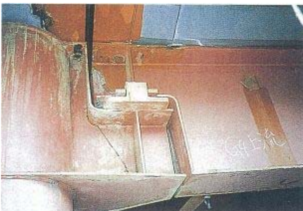
ゲルバー部に発生した亀裂
