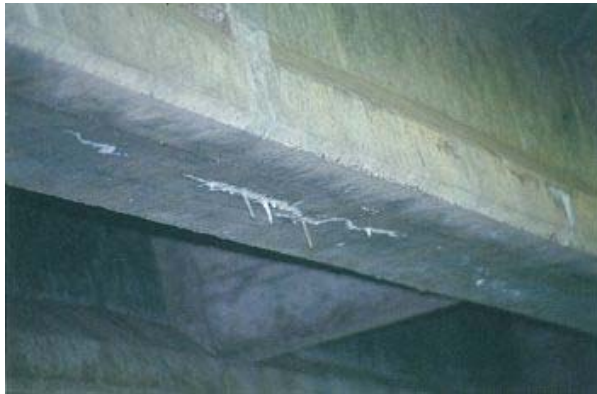
PCT 桁のひびわれ (遊離石灰を伴う)
