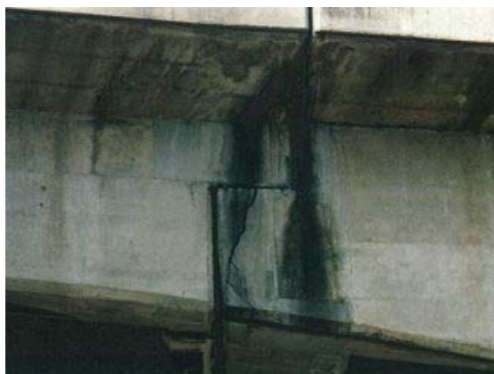
ゲルバー部のひびわれ
