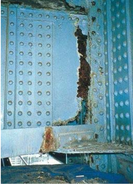
縦桁腹板の断面欠損
