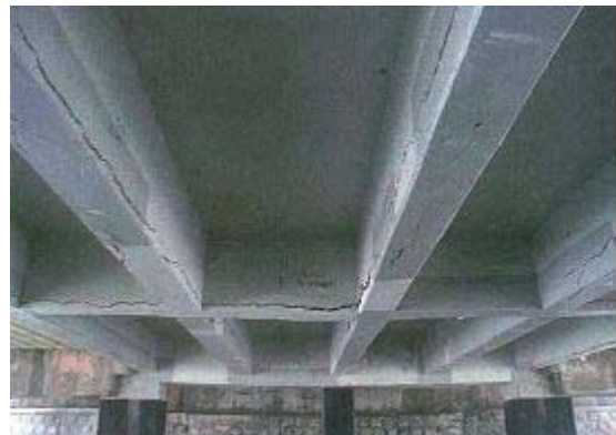
塩害劣化した RCT 桁橋
