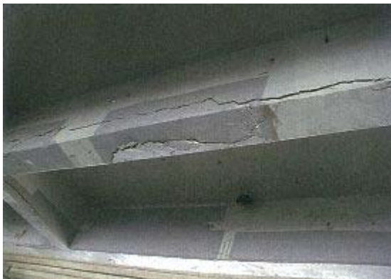
塩害劣化した RCT 桁橋
