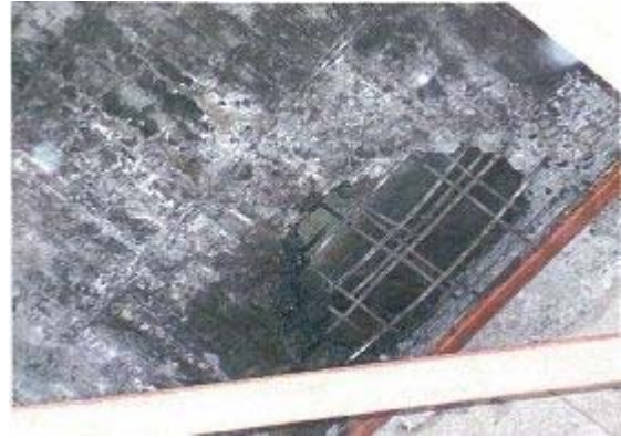
抜け落ちが発生した状況
