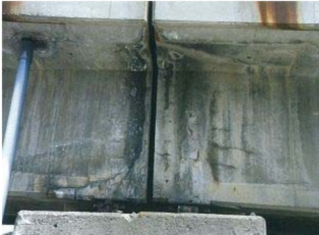
ASR と想定されるひびわれ (PCT 桁)
