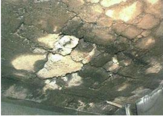
抜け落ち寸前の床版
