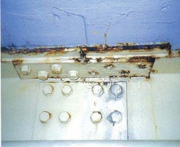
上フランジ接合ボルトが多数脱落
