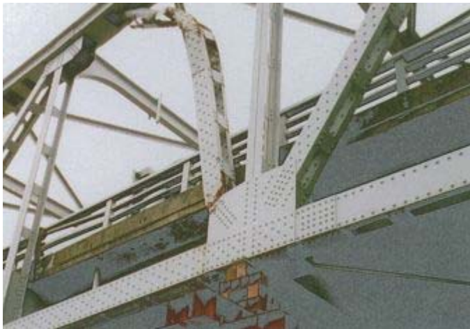
トラス橋斜材の破断
