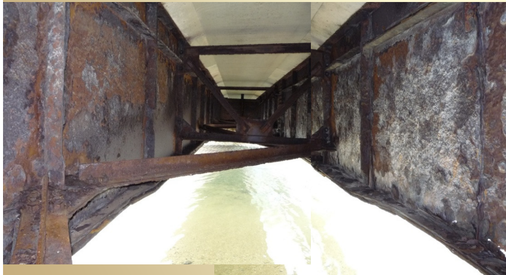
橋梁内部の激しい塩害劣化
