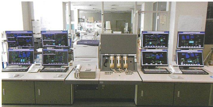
▲中央監視・制御システム
