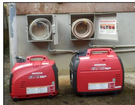
非常用LPガス発電設備
