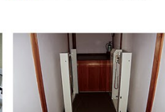
↑施設内の車いす昇降機
