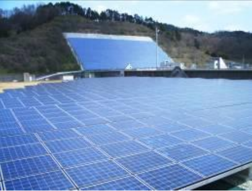
☐太陽光発電システム(御所浄水場)
