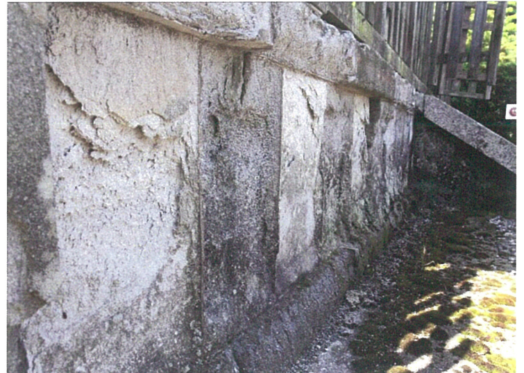
當麻寺西塔 基壇破損状況
