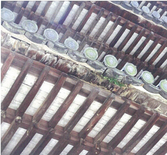
當麻寺西塔 初層軒先破損状況
