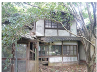
老朽化が進む旧青少年会館
