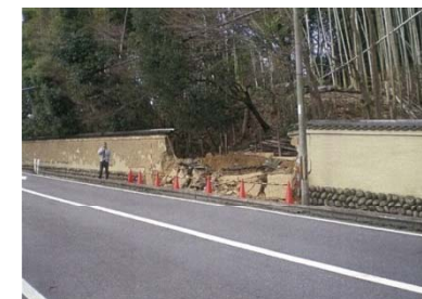
塀の倒壊(平成22年当時)
