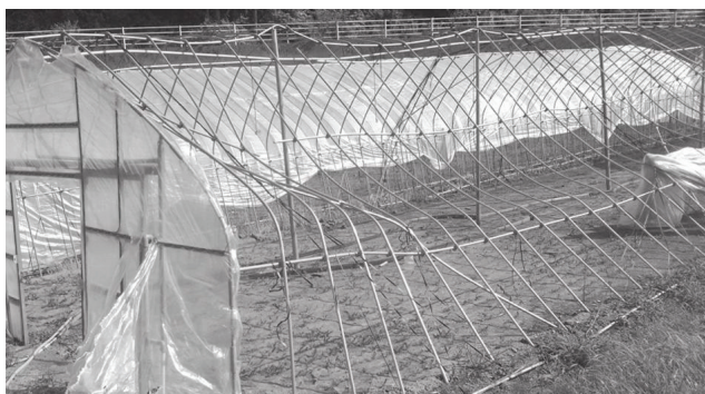
第6図 支柱は倒れず倒壊したパイプハウス
