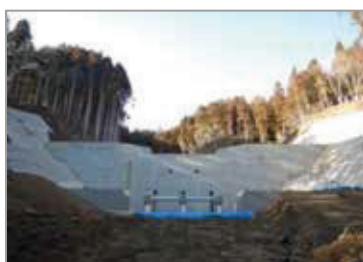
▲避難所を保全する砂防施設 (菅爾村掛)
