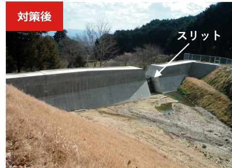
▲スリットの追加により、土砂と流木の捕捉効果が向上 (写真:葛城市兵家 太田川)
