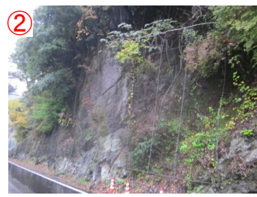
写真2 岩盤崩落の危険性が高い箇所
