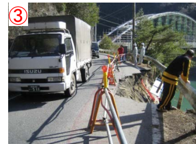
写真3 路肩決壊状況 (H18.3.13発生)
