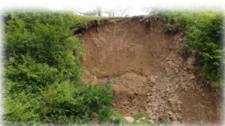
※北側崩落地（令和5年崩落）
