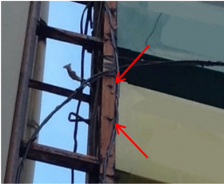
取付部(ボルトのゆるみや欠落)
