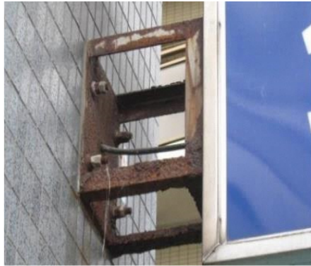
接合部(ブラケットの腐食劣化)
