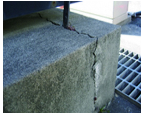
基礎部(基礎のクラック)
