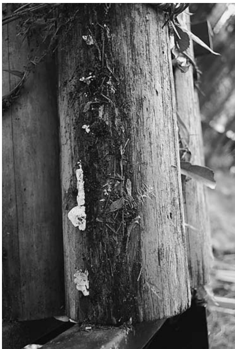
図7 側面に発生した腐朽と子実体
