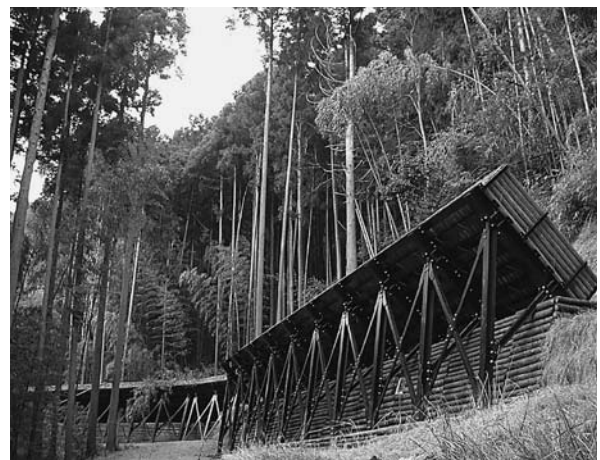
図1 落石防止壁と調査地の状況
