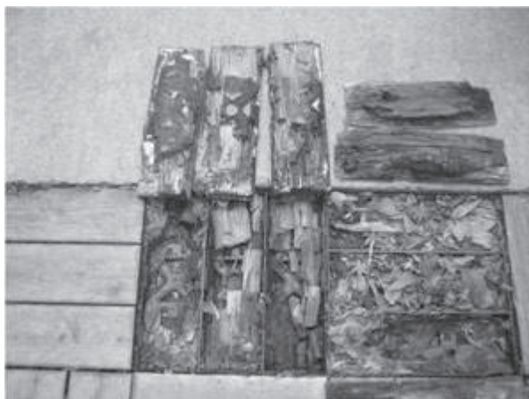
図4 奈良女子大学国際交流プラザの木製舗道材の腐朽劣化（施工後6年経過）
