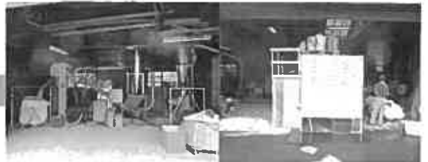
木質ペレット製造装置
