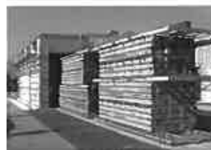
木材乾燥設備
