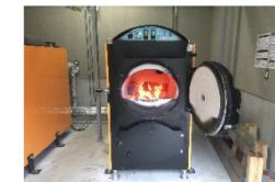
福祉施設への 薪ボイラー導入 (天川村)
