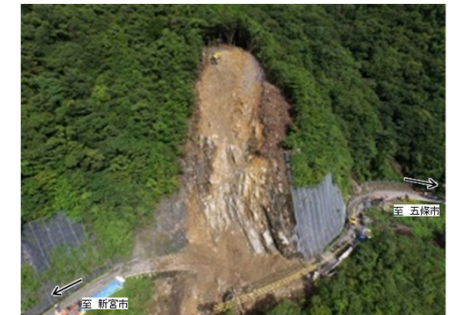
十津川道路(Ⅱ期)区間 (H27年7月 大規模法面崩落状況)
